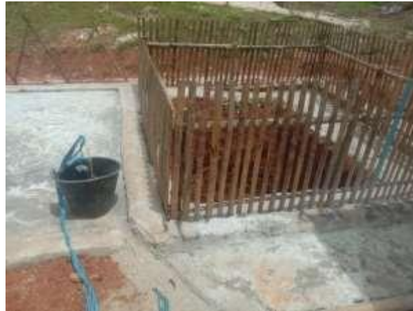
Gambar 5. Hasil Akhir Pemanenan Air Hujan (Sumber: Dokumentasi Pribadi)
